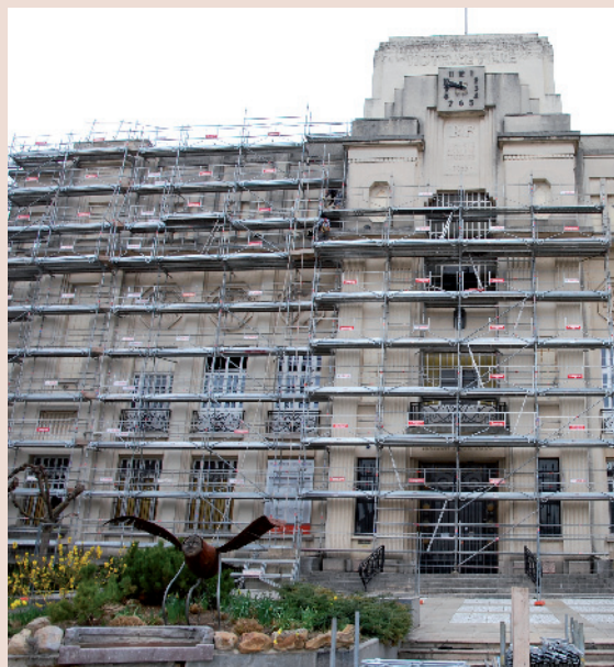
Façade de l'espace culturel Travaux de nettoyage de la façade, remplacements des menuiseries extérieures
